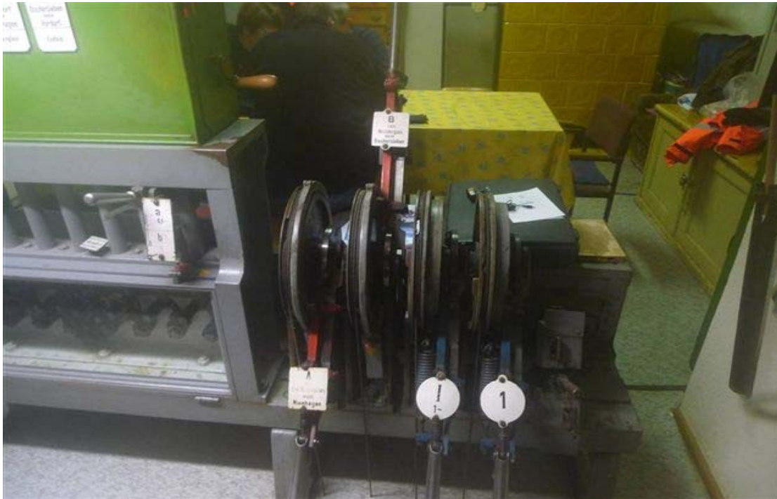
Bild 4: Stellwerk, Üst Hordorf
