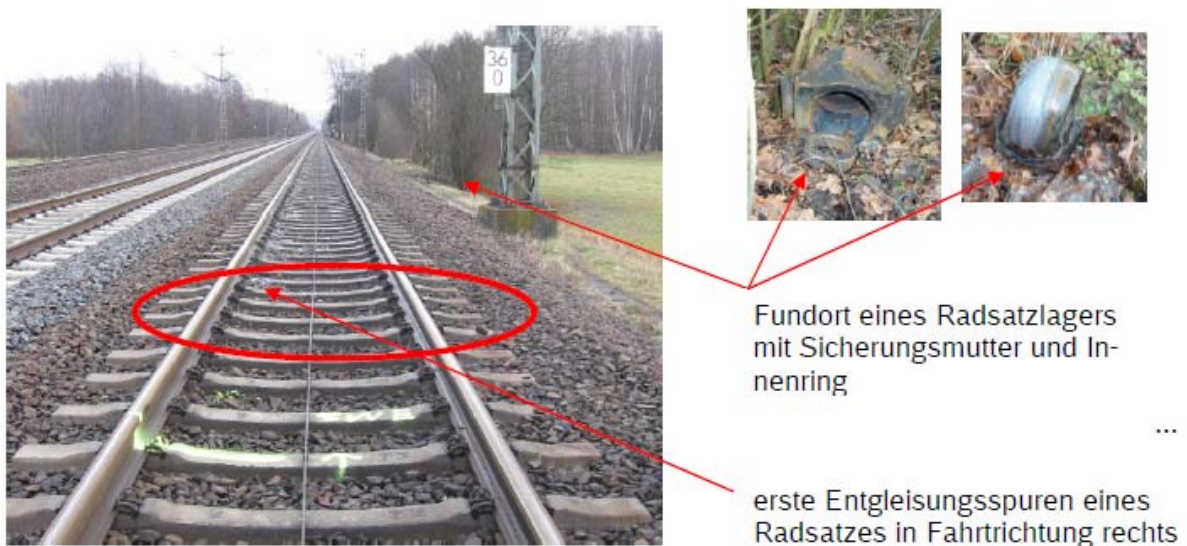
Abb. 11: Entgleisungsstelle in km 35,985
